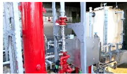
消火栓・スプリンクラー実習設備
