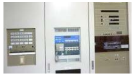
防災センター実習設備
