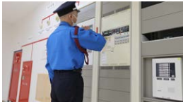
自動火災報知設備の操作訓練
