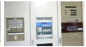
防災センター実習設備
