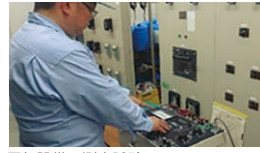
電気設備の測定試験
