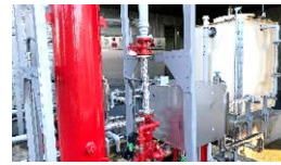
消火栓・スプリンクラー実習設備
